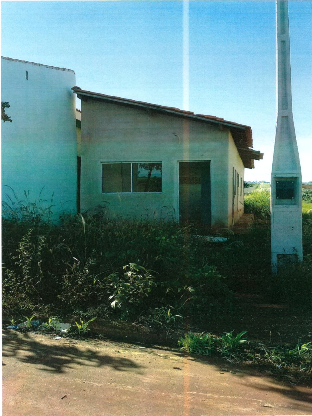
CASA SEMI PRONTA EM ESTADO DE DEPREDÇÃO
